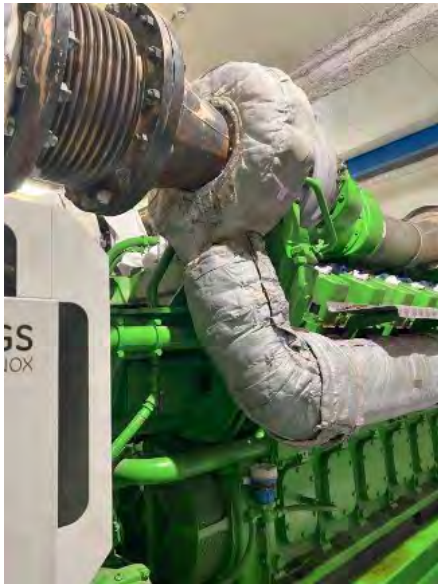
Fig.1: Thermisch geïsoleerde gasmotor
