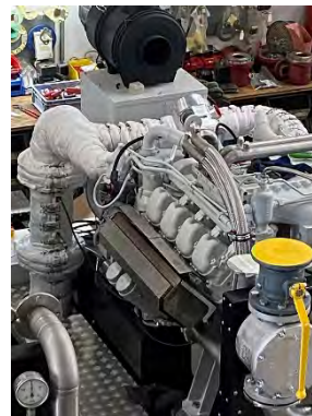
Abb. 70/Abb.71 Abgasleitung BHKW Calciumfrei isoliert
